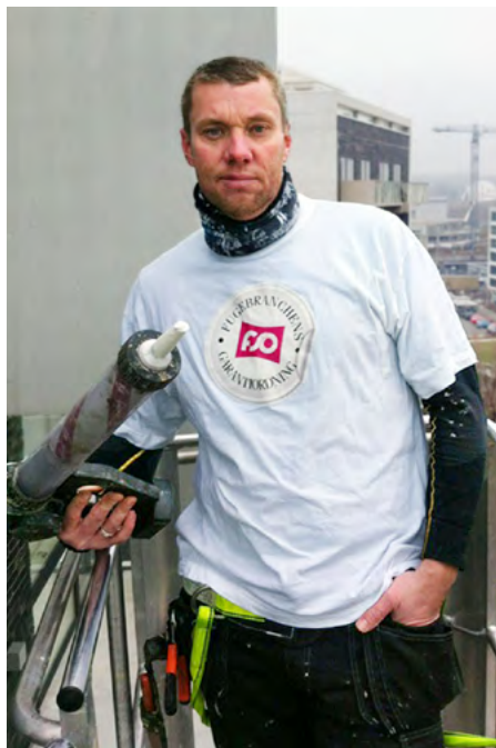
Facadeelementerne bliver fuget i 45 meters højde. Det er på Åhusene i Århus og arbejdet udføres af Freddy Hansen fra Fugebillen ApS.
